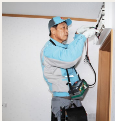
▲分電盤のチェック
