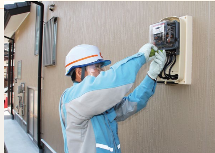
▲メーター結線の締付け確認
