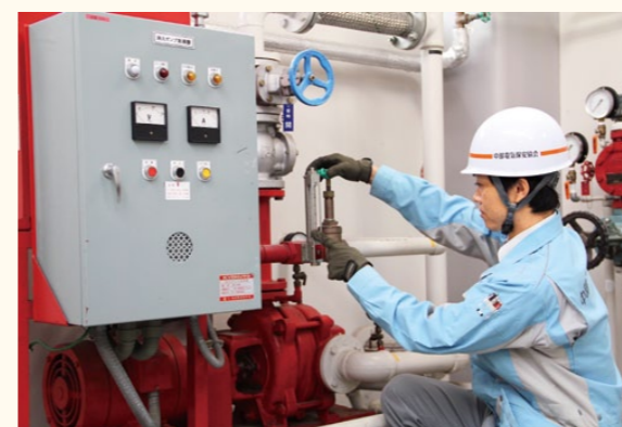
▲消火栓起動装置の起動試験
