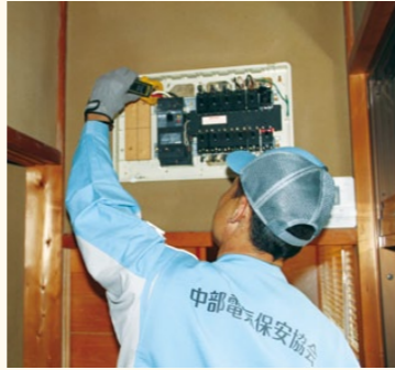
▲分電盤の安全点検
