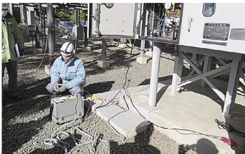
特高遮断器の試験実習
