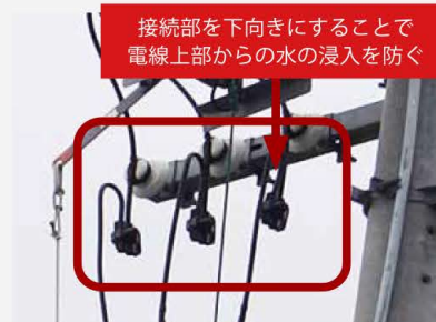
写真③ 割線（高圧機器と高圧ケーブルの接続用電線）
