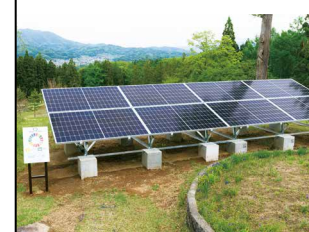
黒姫コースに導入された オフグリッド設備
