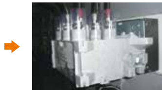
取替後のVCB
