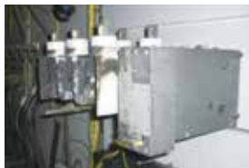
焼損したVCB
