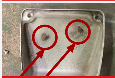
端子カバーに接触して漏電
