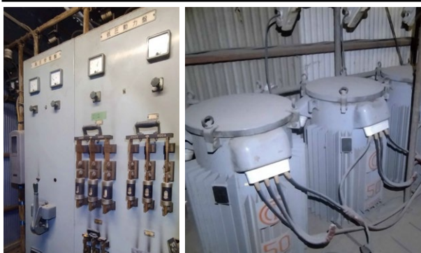
更新前[屋内組立式受電設備]
