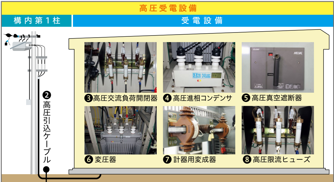
経年劣化により故障した事例①
