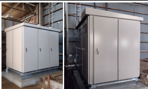
更新後[キュービクル]
